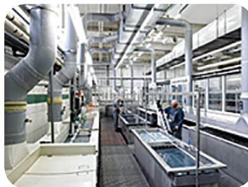
شکل ۶. تصاویری از واحدهای آبکاری مجهز به سیستم درب و هواکش
